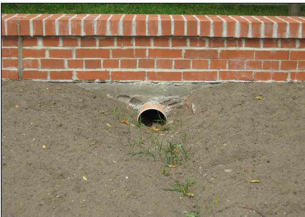
Bild 10 Im Sommer 2012 wurde auf die Schloßgartenmauer „draufgemauert“. Die mangelhafte Qualität sorgt nicht gerade für Akzeptanz in der Bevölkerung. Links eine Dehnungsfuge.
