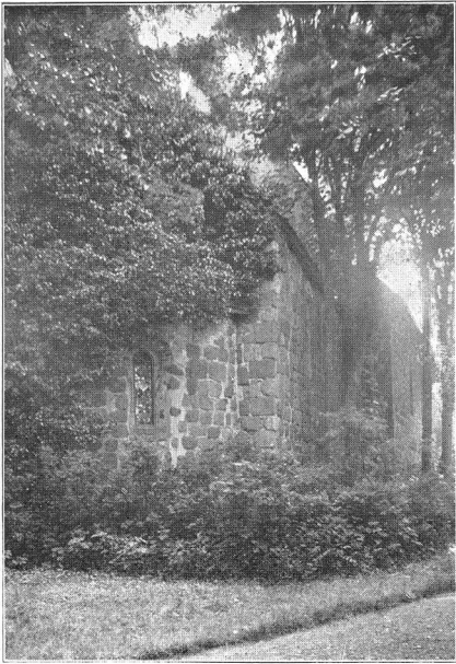
Nr. 23. Schmiedeberg. Das unsaubere Mauerwerk in der Ecke beweist, daß die Apsis erst nachträglich angefügt wurde.
